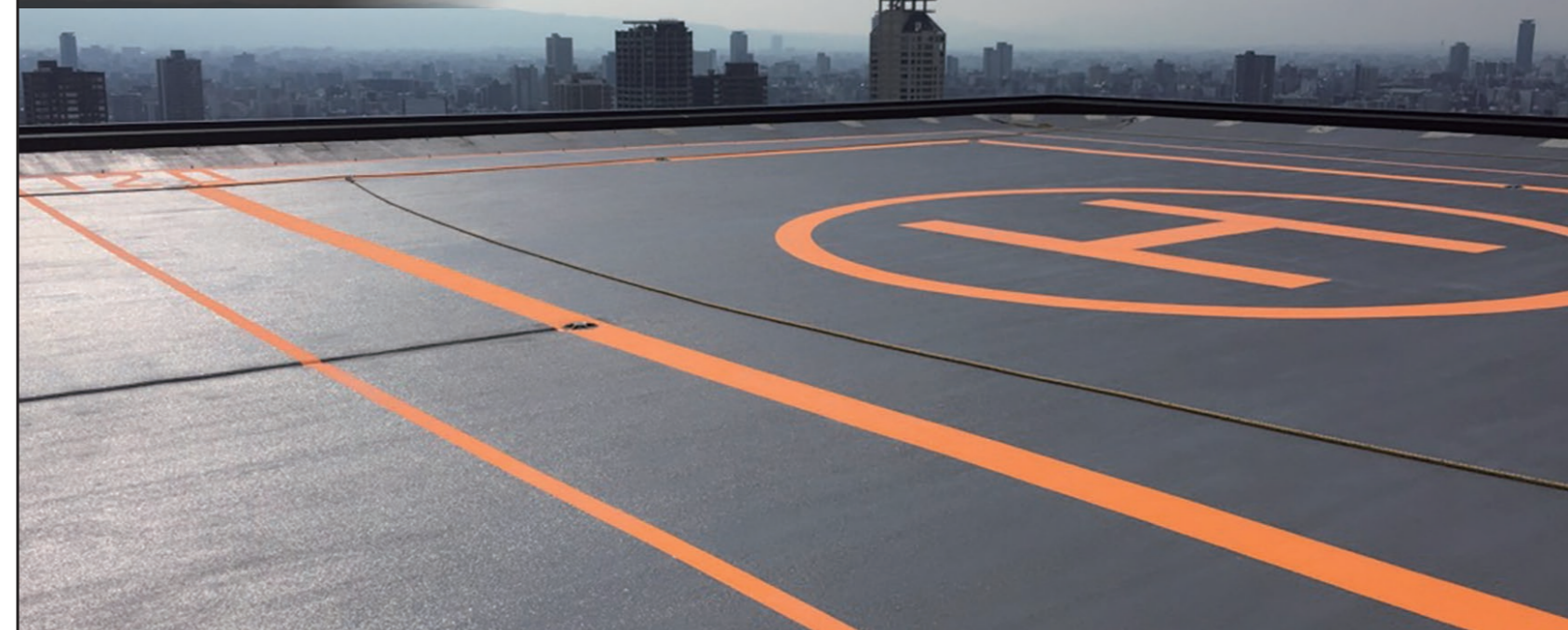
ウレタン・FRP複合塗膜防水 某ホテル屋上ヘリポート
